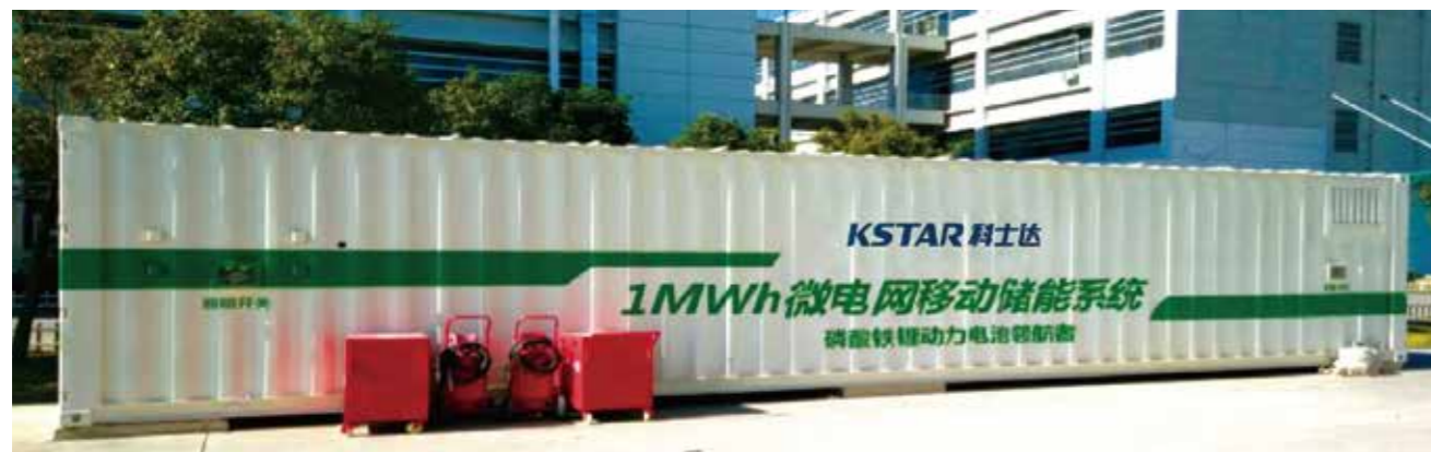
► 3 MW/12 MWh BESS-Demonstrationsprojekt in Shenzhen
