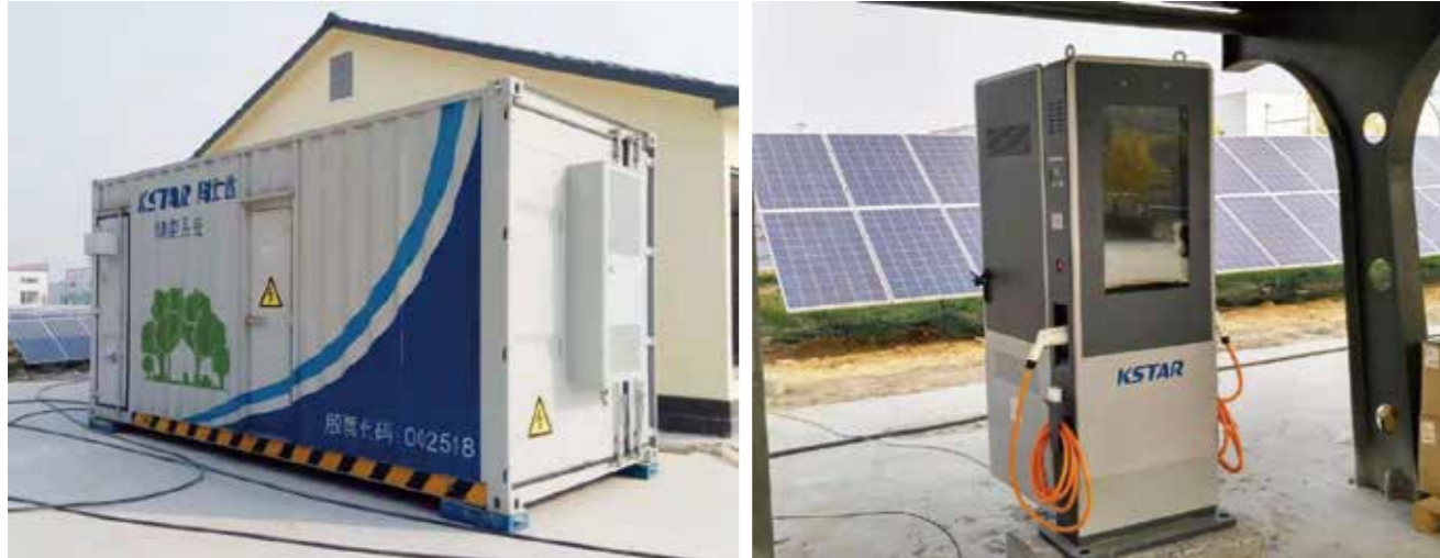
► 50 kW/200 kWh BESS für EV-Ladestation in Hebei
