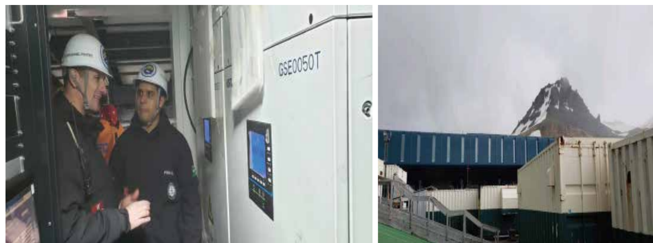
► 300 kWh Speicherprojekt der Antarktis-Forschungsstation des brasilianischen Militärs
