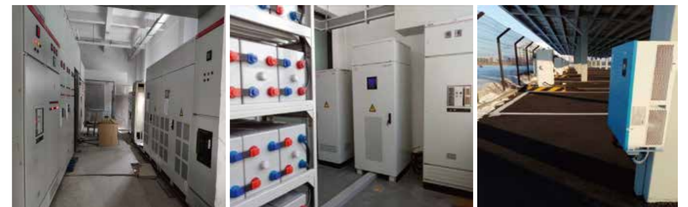
► BESS für EV-Ladestation in Harbin
