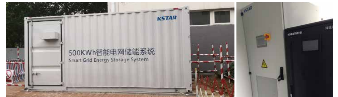
► 500 kWh Multi-Energie-Ergänzungsprojekt im Industriepark Beike
